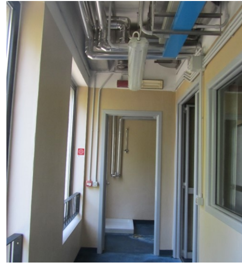
Fig. 15: Corridoio e filtro di accesso stabulari
