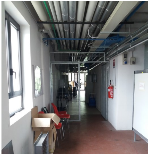
Fig. 04: Corridoio da locale filtrazione
