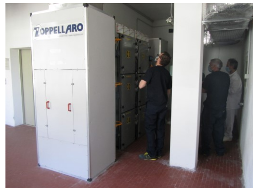
Fig. 16: Zona di filtrazione meccanica stabulari
