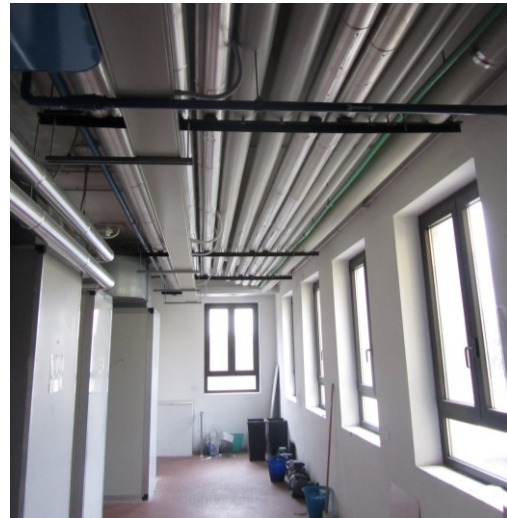
Fig. 05: Vista impianti di filtrazioni
