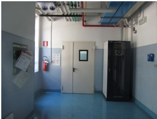
Fig. 11: Zona accesso pass-box
