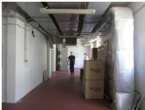
Fig. 21: Zona di filtrazione meccanica
