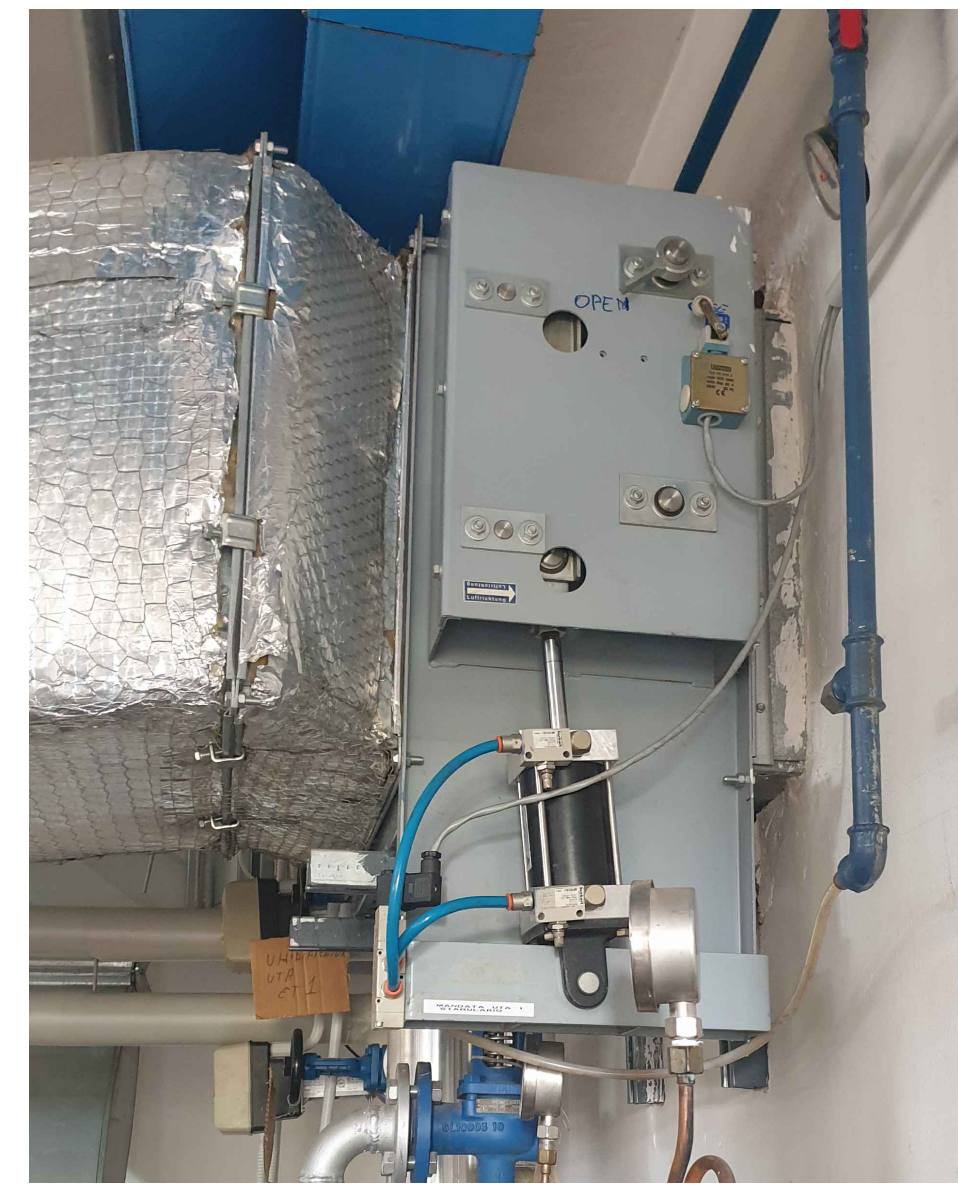
2 - Serranda di intercettazione a tenuta esistente da riposizionare
