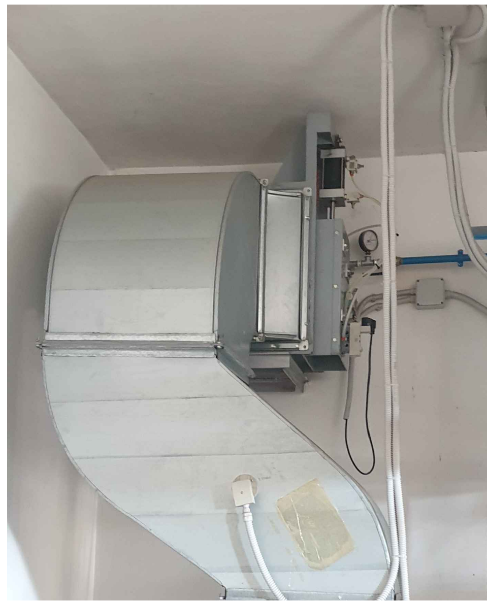
1 - Serranda di intercettazione a tenuta esistente da riposizionare
